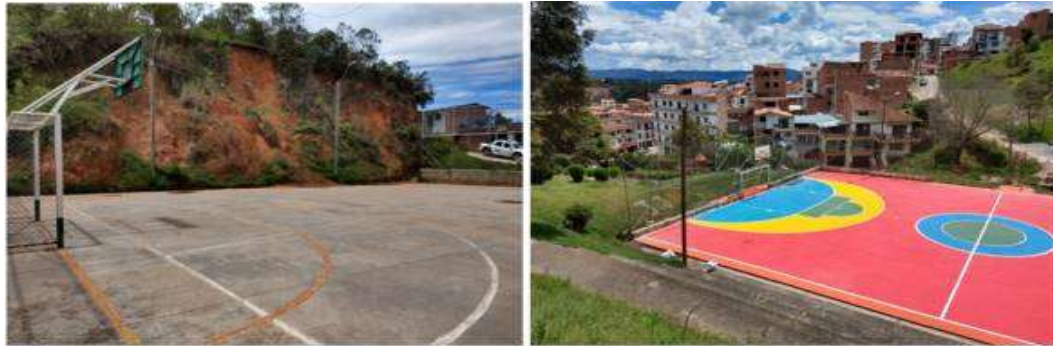
Barrio Tinajas y Barrio La Colina respectivamente. Se observa que aun no se ha iniciado con la ejecución de obra. Se debe prestar atención al talud aledaño el cual se ve afectado por las aguas lluvias . Fuente: Visita al sitio equipo auditor Elaboró: Jaime Andrés Grisales Gallego/profesional Universitario
