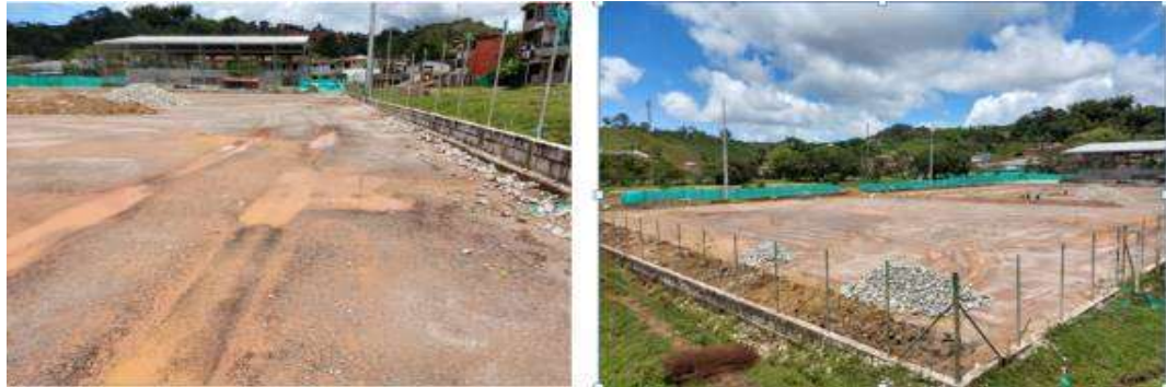
Estado actual de la obra sin terminar afectando la comunidad que practica el deporte del fútbol Fuente: Visita al sitio equipo auditor Elaboró: Jaime Andrés Grislaes Gallego/profesional Universitario
