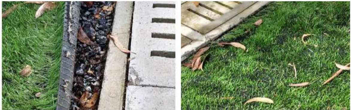
Nivel del cárcamo más alto que la grama sintética está generando estancamiento en los costados laterales Fuente: visita al sitio equipo auditor
