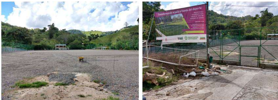
Caracolí estado actual de la obra sin terminar afectando la comunidad que practica el deporte del fútbol. Fuente: Visita al sitio equipo auditor Elaboró: Jaime Andrés Grisales Gallego/Profesional Universitario
