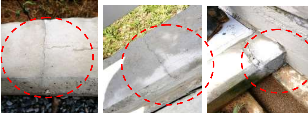
Foto: Captura cancha de fútbol. Concordia - Antioquia Grietas y fisuras sobre elementos de concreto Elaborado: Juan Pablo Madrid García – Contralor Auxiliar.
