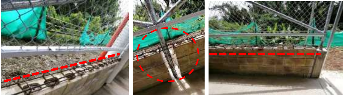
Foto: Captura cancha de futbol. Valparaíso - Antioquia Oxidación de aceros y refuerzos expuestos a condiciones climáticas sin protección Elaborado: Juan Pablo Madrid García – Contralor Auxiliar
