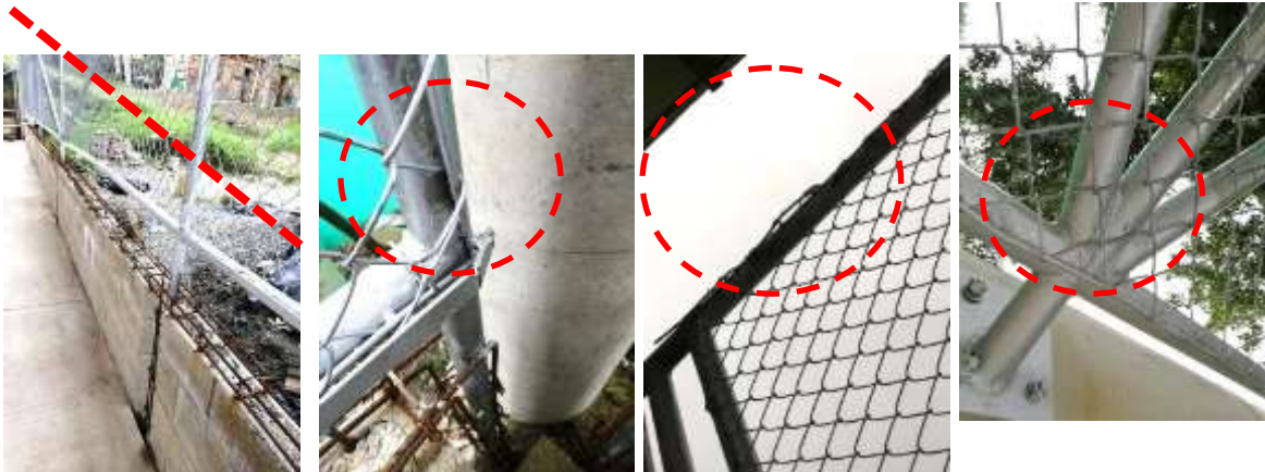
Foto: Captura cancha de fútbol. Valparaíso - Antioquia Conformación deficiente sobre la malla eslabonada
