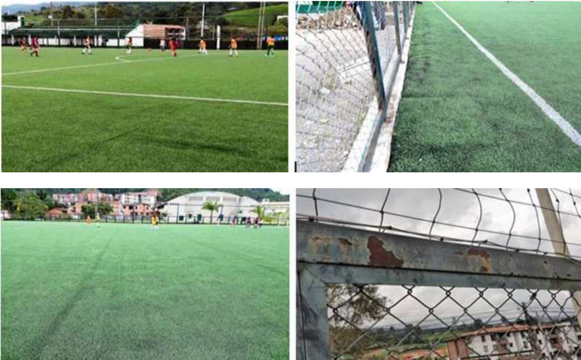
Estado actual de la obra donde se observa el problema en los empates y los laterales de la cancha Fuente: Visita al sitio equipo auditor Elaboró: Jaime Andrés Grisales Gallego/Profesional Universitario
