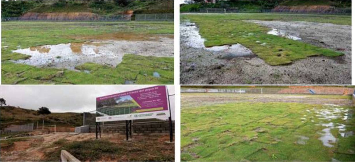
Estado pésimo de la obra sin terminar afectando la comunidad que practica el deporte del fútbol, lote inundado con pedazos de grama. Fuente: visita al sitio equipo auditor Elaboró: Jaime Andrés Grislaes Gallego/Profesional Universitario
