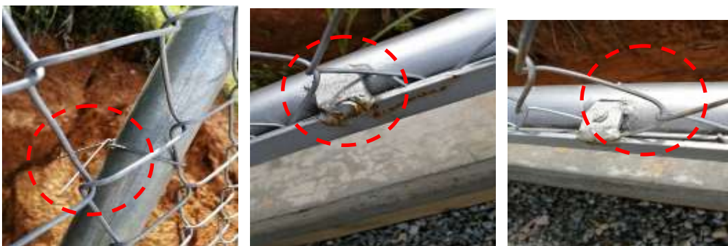
Foto: Captura cancha de fútbol. Concordia - Antioquia Cerramiento amarres deficientes - oxidación de soldadura Elaborado: Juan Pablo Madrid García – Contralor Auxiliar.
