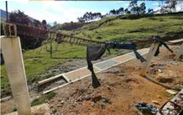
Foto: Captura cancha de fútbol. Angelópolis - Antioquia Aceros expuestos a condiciones climáticas sin protección Elaborado: Juan Pablo Madrid García – Contralor Auxiliar
