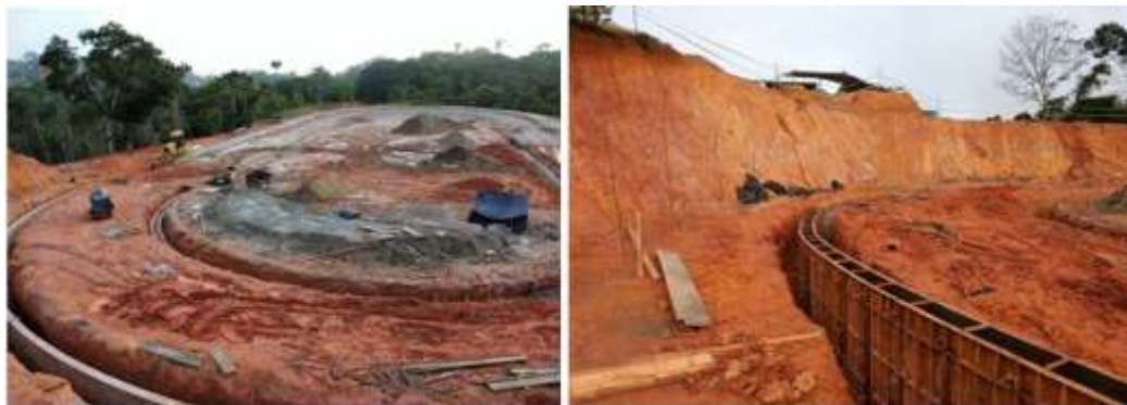
Se debe tener principal atención con el talud que quedo muy cerca a la pista y podría generar un riesgo por su cercanía y corte. Fuente: Visita al sitio equipo auditor. Elaboró: Jaime Andrés Grisales Gallego/Profesional Universitario
