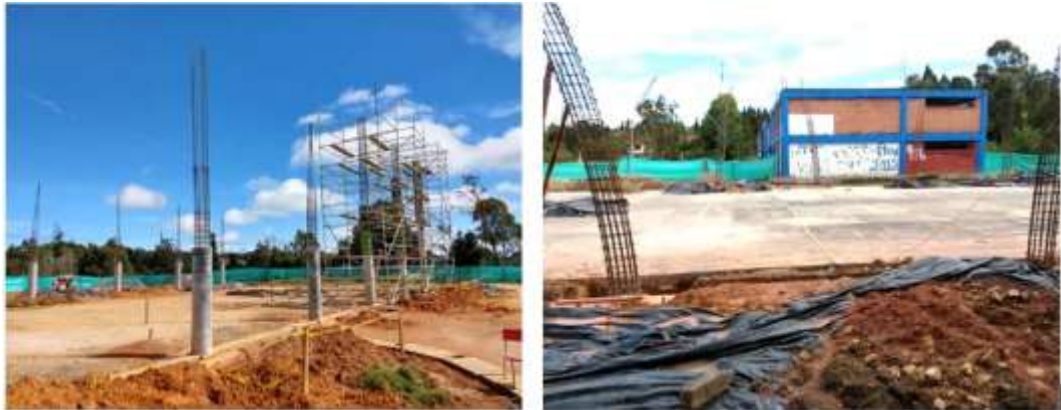
Guarne Vereda Piedras Blancas / Vereda Hhojas Anchas, estado actual de las obras retraso del plazo.. Fuente: visita al sitio equipo auditor Elaboró: Jaime Andrés Grisales Gallego/Profesional Universitario
